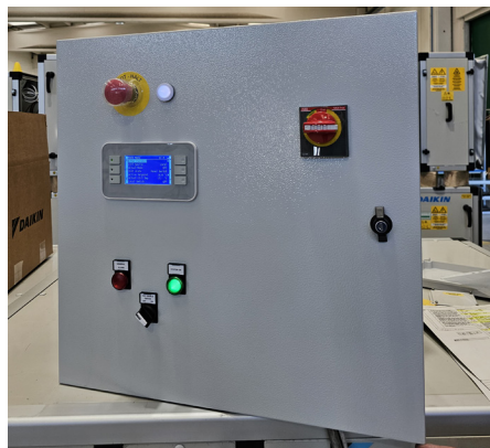
Электрощит Digital External
